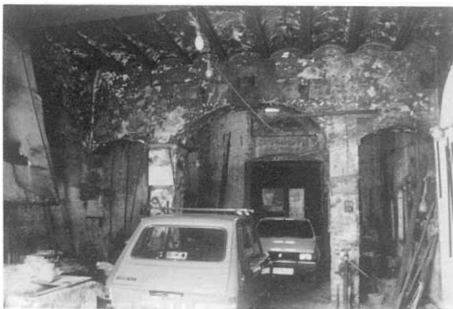
Las arcadas del patio son la excepción en la arquitectura adintelada del edificio.
